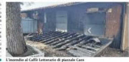
L'incendio al Caffè Letterario di piazzale Caos
